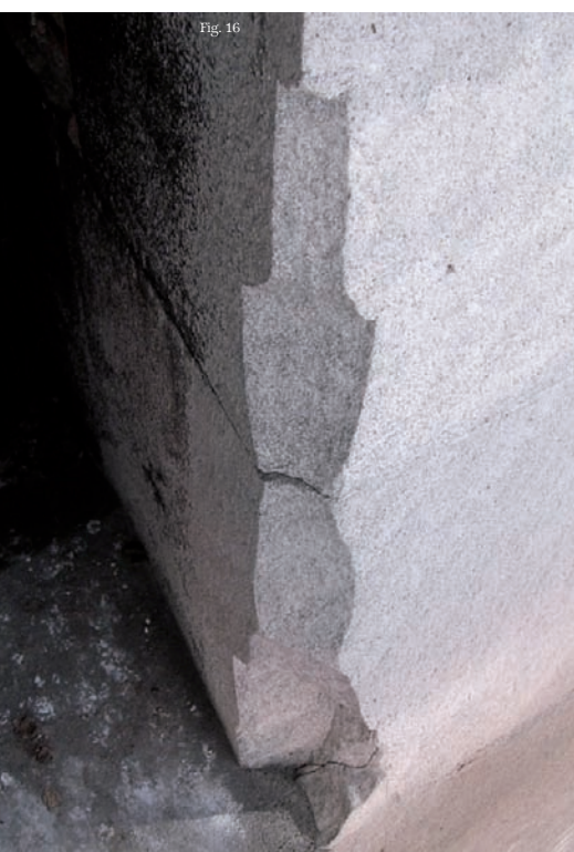
Fig. 16 Mancanza legata all'espulsione di frammenti di roccia fratturati per schiacciamento. Granitello, lato ovest, quarto piano. Loss by expulsion of rock fragments on the edge of granitello blocks crushed by compression. Fifth floor, western façade.
