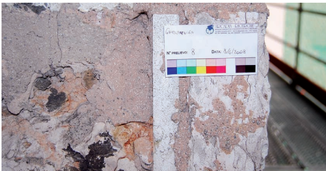
Fig. 12 Area in cui sono evidenti i rifacimenti con impasto a base di resina epossidica Area showing visible signs of repairs using epoxy resin mortar.
