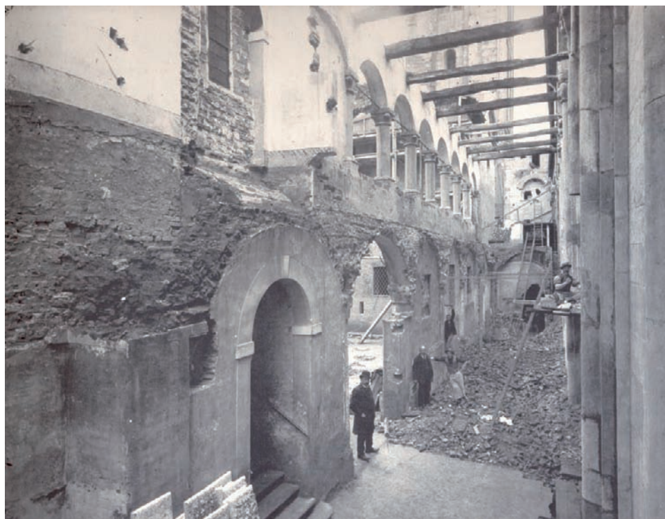
Fig. 6 Pianta storica (con indicate in giallo le demolizioni) e foto dei lavori. Historical blueprint (demolitions are shaded in yellow) and photos of the work.
